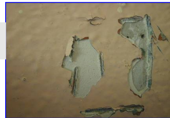
Enduits plâtre anti-bullage amianté
